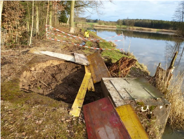
Durch den Biber untergrabene Weiherdämme erfordern eine Dammsanierung
